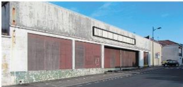
L'un des objectifs du plan local d'urbanisme intercommunal sera d'intervenir sur les friches ou les dents creuses des bourgs de son territoire. | Photo : OUSSEFRANCK
